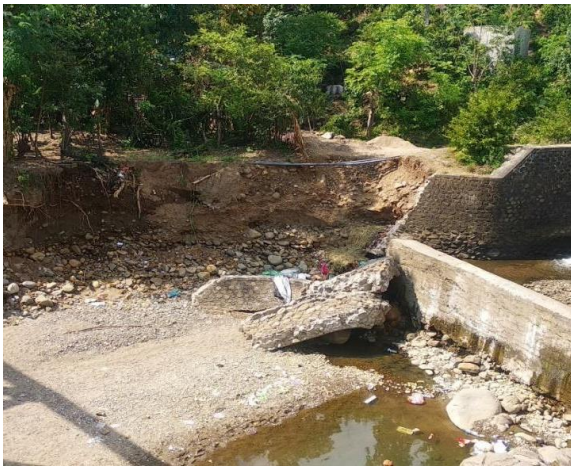
Bendung Daha II, Kab. Dompu, NTB (Sebelum Penanganan)
