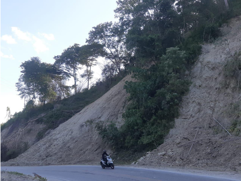
Gambar Ruas Jalan yang Mengalami Longsoran
