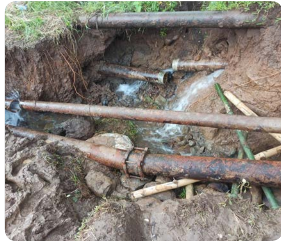
Kerusakan Jaringan Pipa di Desa Cibulakan, Kecamatan Cugenang
