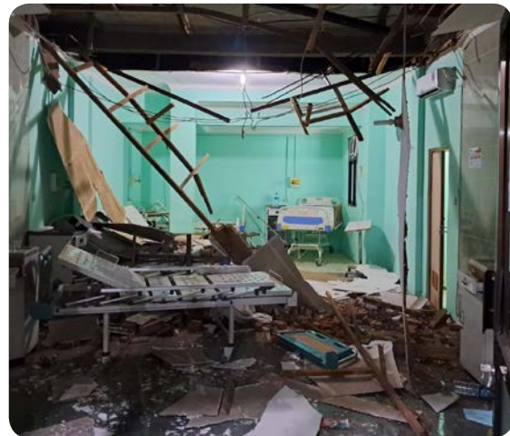
Kerusakan Bangunan di RSUD Sayang
