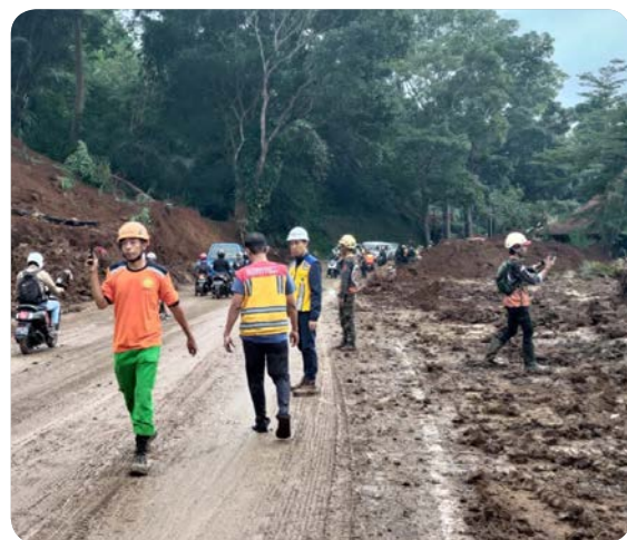
Berbagai Dampak Kerusakan Gempa Cianjur 2022
