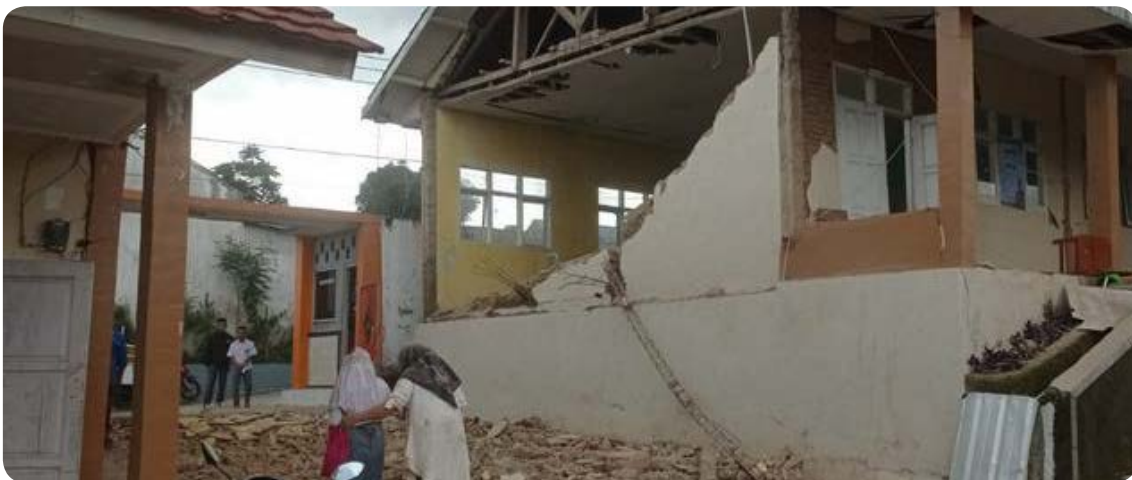
Struktur Kolom dan Balok Kuat Tetapi Dinding Lemah
