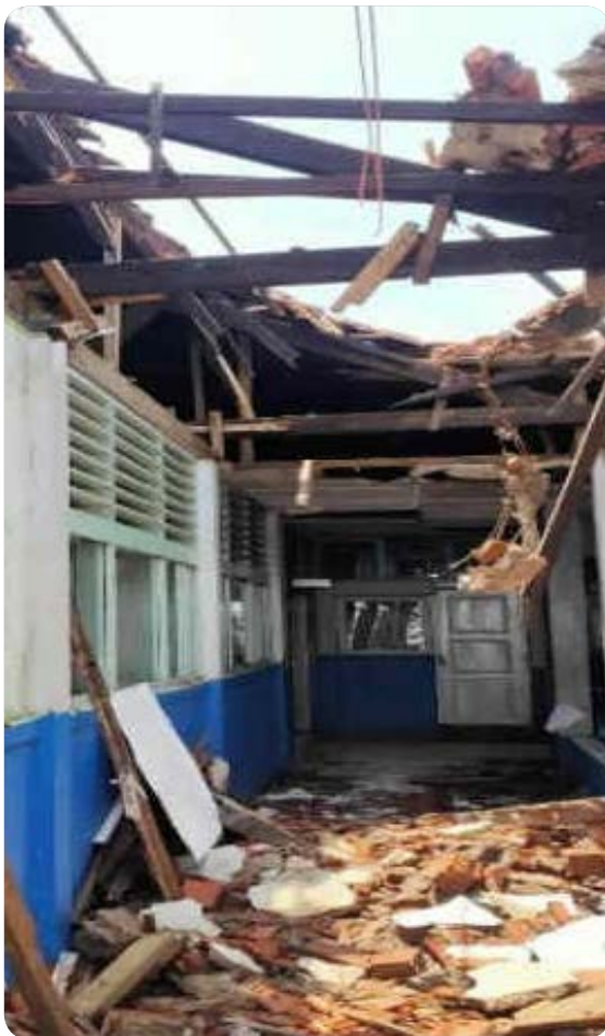
Kerusakan Bangunan di SMPN 1 Warungkondang
